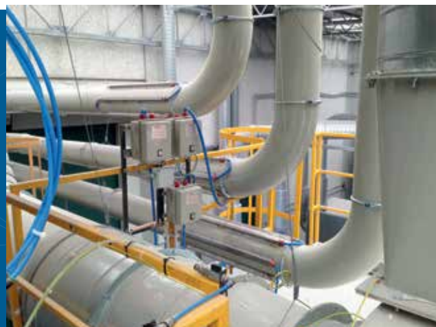
Clear Tube installato su tratto di tubazione prima dell'uscita dallo stabilimento.
