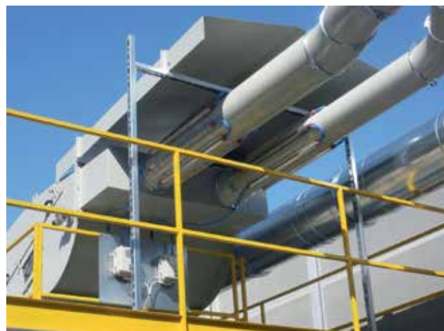
Installazione Clear Tube posta all'ingresso di un separatore.
